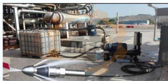
Tuần hoàn hóa chất và rửa lại bằng áp lực bên trong Chemical circulating & High pressured water jet
