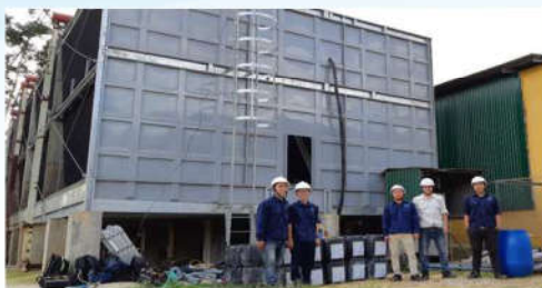
Tuần hoàn hóa chất & xịt tháp giải nhiệt 12,000 RT Chemical circulating & Water jet for cooling tower
